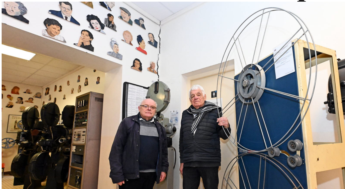
Jean-Claude Martin et Alain Drillon, respectivement président et vice président, sous l'une des nombreuses fissures qui lézardent désormais le bâtiment. Photo Cedric Jacquot
